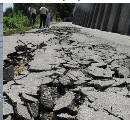
Schäden an der Verkehrsinfrastruktur durch Hochwassereinwirkung (Bulgarien, Juli 2005)
