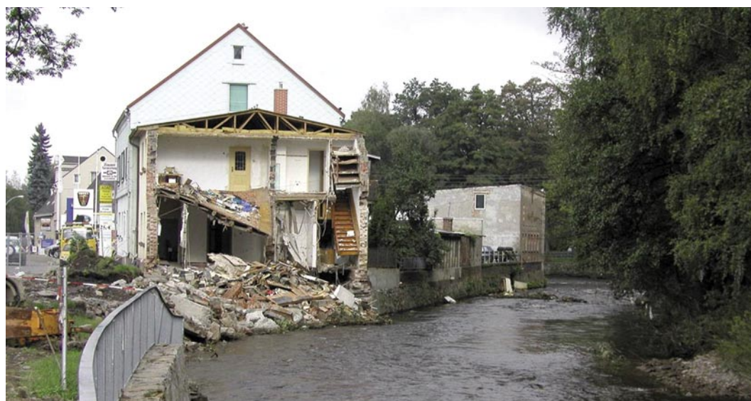
Durch das Hochwasser 2002 zerstörtes Wohnhaus an der Flöha
