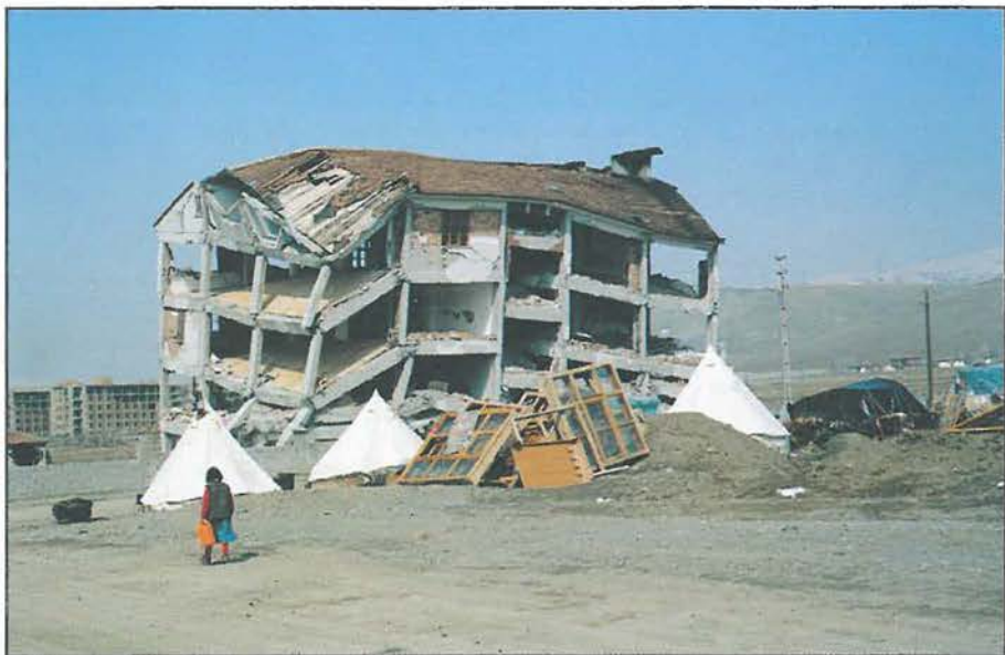
Abb 3: Ein in Skelettbauweise errichtetes Studentenwohnheim am Stadtrand von Erzincan. Das Fehlen von Scherwänden und die gleichartige Dimensionierung aller Pfeiler ließ das Gebäude zu einem Beispiel der Mißachtung von Prinzipien erdbebensicherer Bauens werden.
