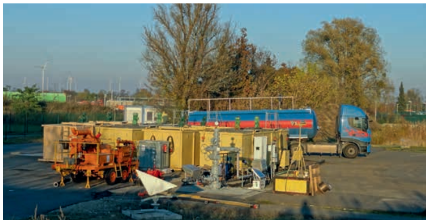
Anlieferung und Zwischenspeicherung von Sole für die kontinuierliche Injektion in 630 m Tiefe, Ketzin/Havel, Oktober 2015 (Foto: T. Kollersberger, GFZ)
