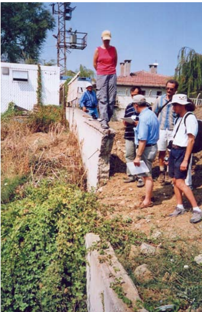
Abb. 1: Koseismischer Versatz einer Mauer in der Stadt Gölcük 10 km südwestlich von Izmit nach dem Izmit-Erdbeben 1999 mit einer Magnitude von 7,4.
