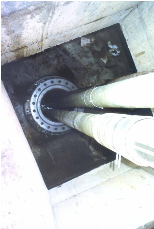
Abb. 6: Parallelinstallation von Pumpen- und Injektionsstrang in einer Wärmespeicherbohrung am Reichstagsgebäude (Quelle: Geothermie Neubrandenburg GmbH)
