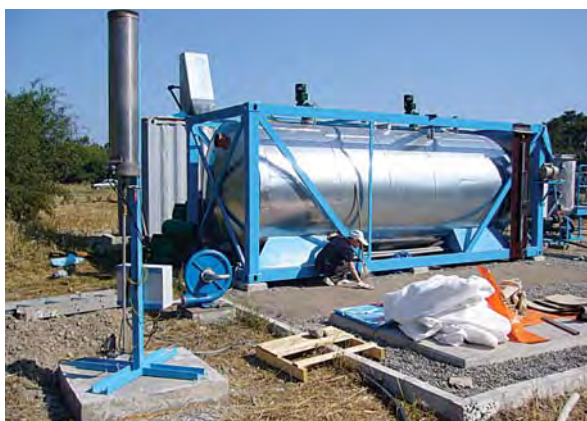
A MODULAARE biogas module
