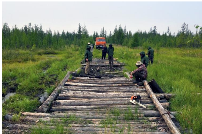
Abb. 2: Die schlechte Infrastruktur in Regionen wie Jakutien wird durch das Auftauen von Permafrost noch stärker leiden. (Foto: Stuart Vyse)
