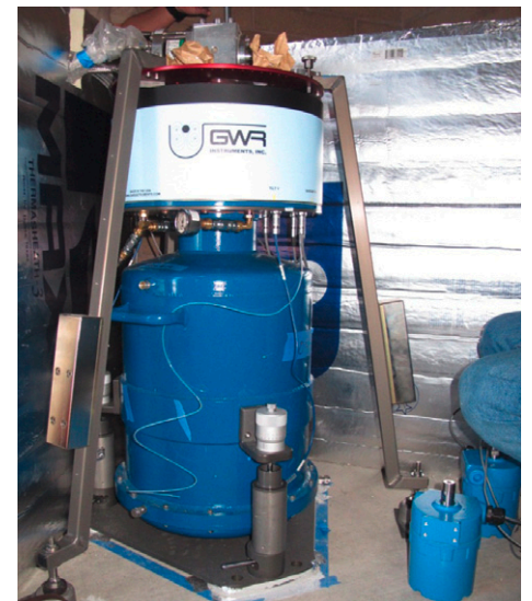
Installation des iGrav-Supraleitgravimeters zur Erkundung der künstlichen Grundwasseranreicherung.
