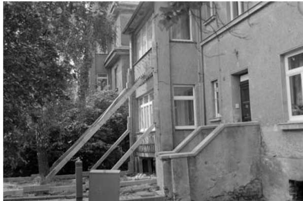
b) Schadensgrad D3: Setzungen, Risse Damage grade D3: Settlements, cracks
