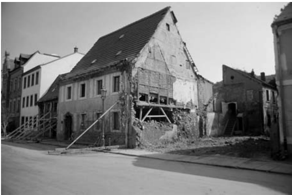
c) Schadensgrad D4: Einsturz von tragenden Bauteilen Damage grade D4: Failure of structural elements
