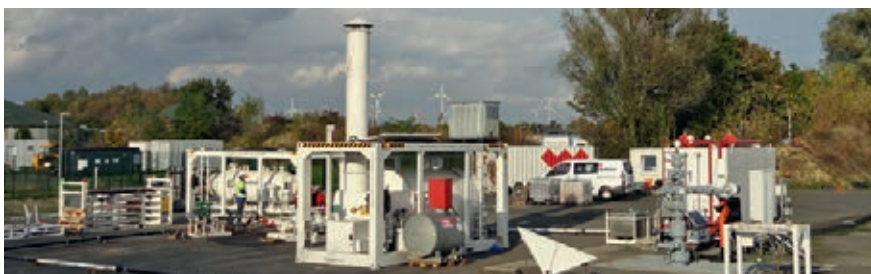
Rückförderung von CO 2 aus dem geologischen Speicher des GFZ in Ketzin, Oktober 2014 (Foto: T. Kollersberger, GFZ)
