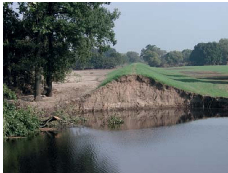
Abb. 1: Deichbruch im Elbeinzugsgebiet während des Hochwassers 2002
