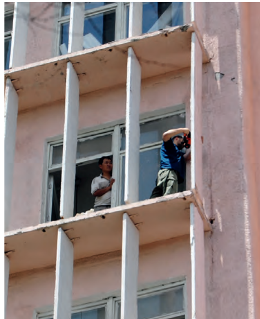
Abb. 4: Installation einer SOSEWIN-Station an der Fassade eines Gebäudes der KSUCTA-Universität in Bischkek (Foto: J. Stankiewicz, GFZ, jetzt ECGS)
